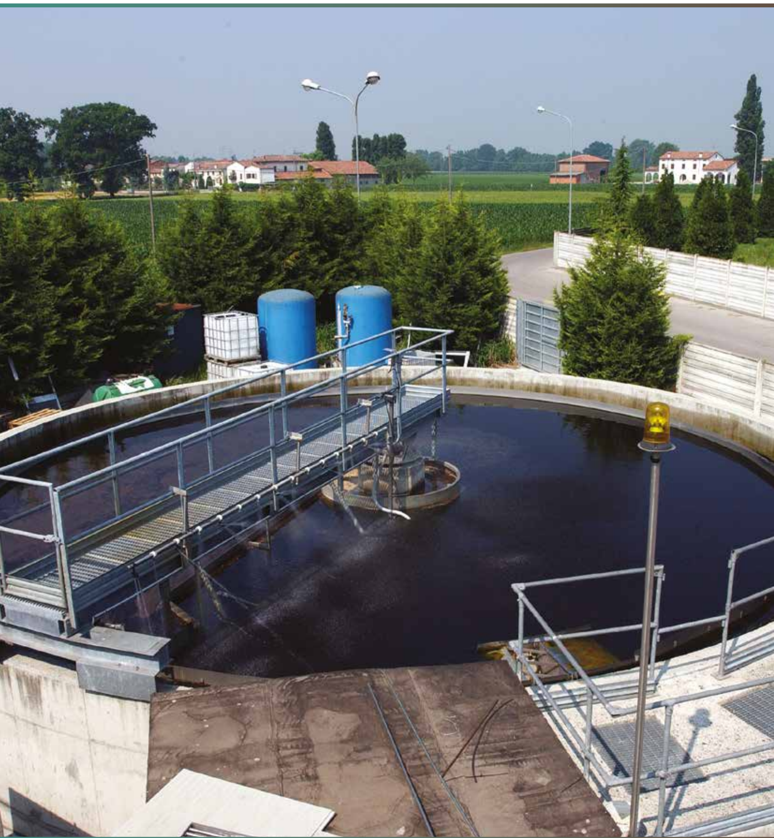
Foto 5.12 Sedimentatore con carroponte Fonte ISPRA Paola Orlandi
