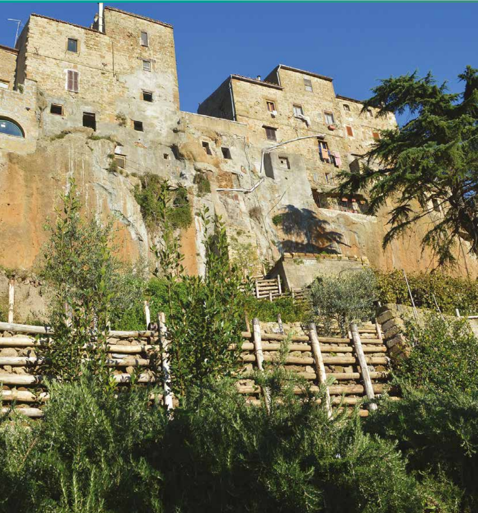
Foto 8.19 Consolidamento rupe tufacea - Intervento 431/02 - Pitigliano (GR) Fonte ISPRA Daniele Spizzichino - Francesco Traversa
